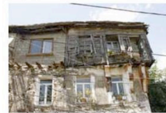
Transformimi dhe degradimi i fasadave.
