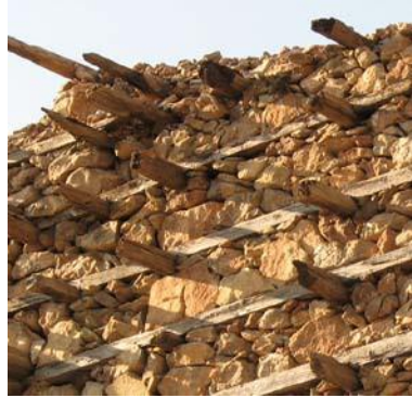
Fig. 3: Buttoning : The characteristic construction technique of the Akseki-İbradı Basin, İbradı - Antalya (Kavas, 2009)
